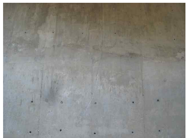
P1 균열(폭0.3mm 이상)
