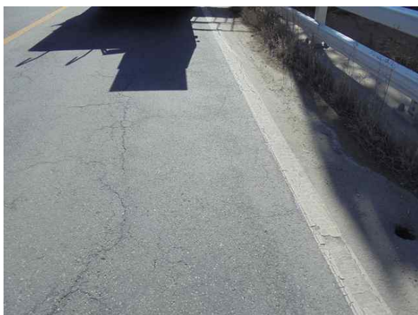
S3 아스콘 망상균열 (3.0m×10.0m)
