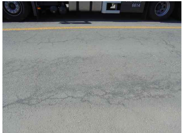
S3 아스콘 망상균열 (3.0m×10.0m)
