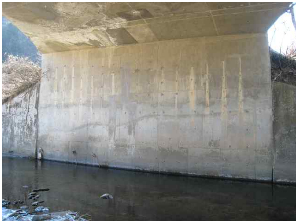
A1 균열(폭0.3mm 미만)
