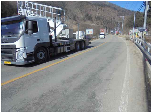
S3 아스콘 망상균열 (3.0m×10.0m)
